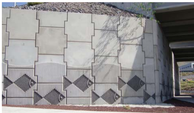
Figura 4.- Muros y estribos en el enlace de Armeñime (Tenerife).
