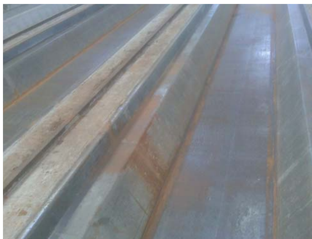
Figura 1.- Aspecto de un molde que presenta rastros de óxido.
